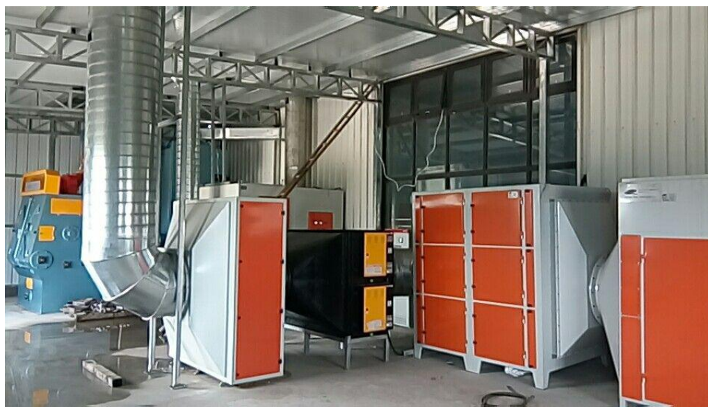
图 4-1 废气处理装置
